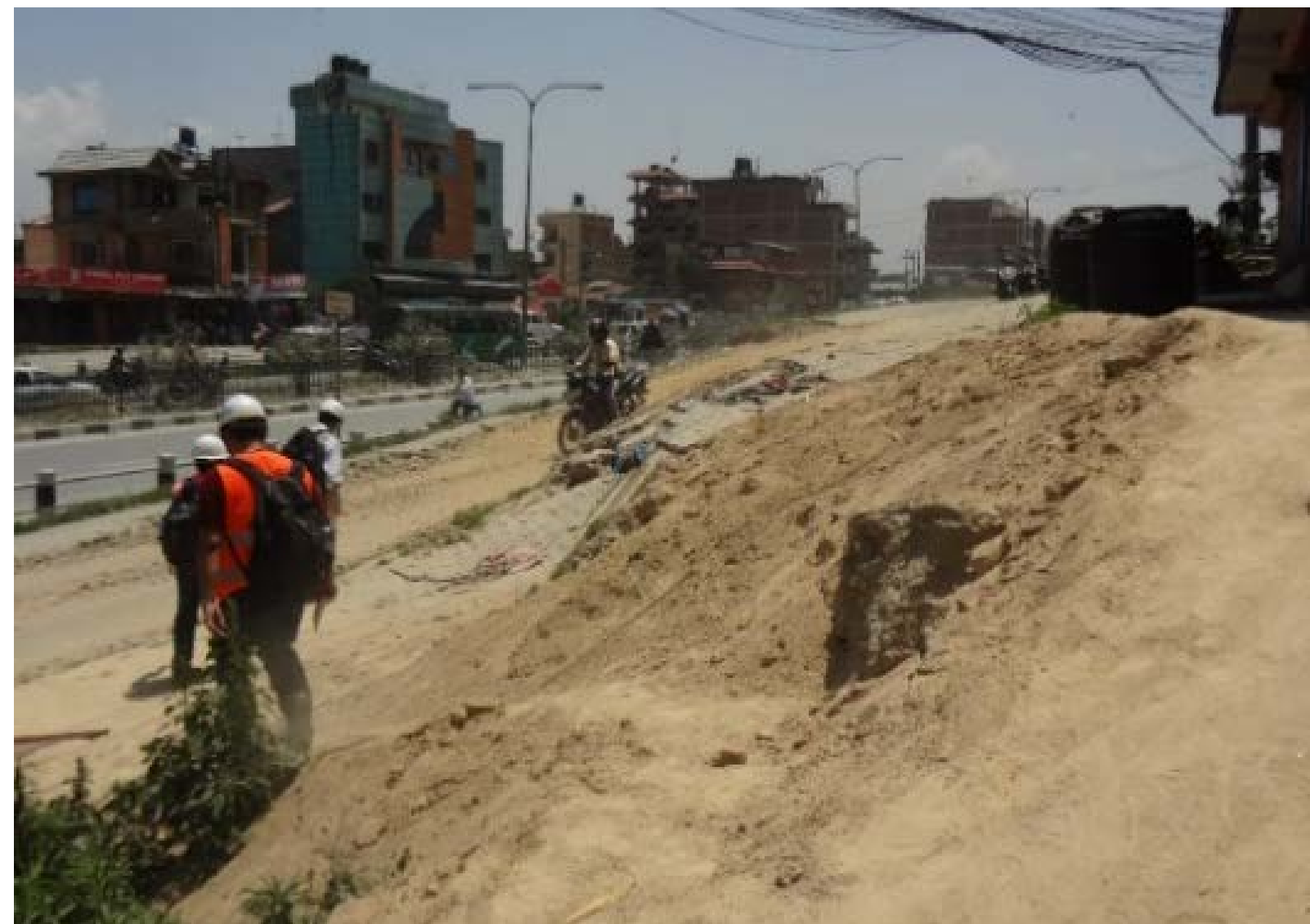
ネパール地震によって発生した高さ1.3mの段差
