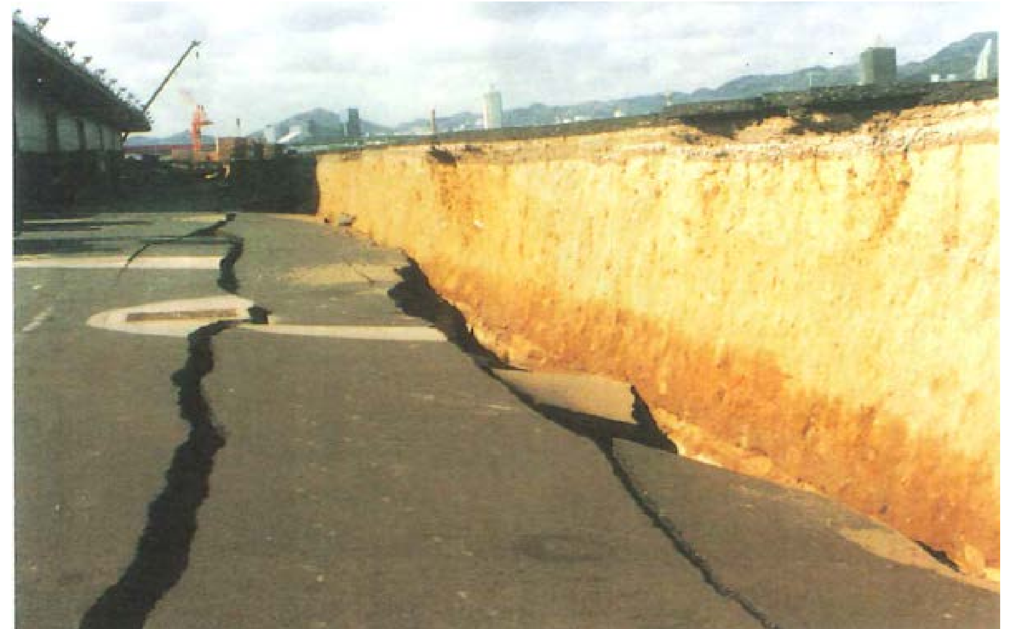
兵庫県南部地震による液状化被害(岸壁背後の陥没) (出典:埋立地の液状化ハンドブック)
